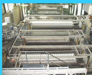
Filterpressen in der Metallaufbereitung
